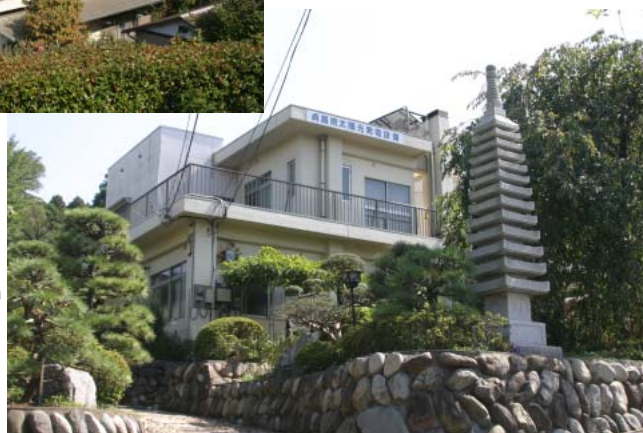
敷地入口からの光景 「貞昌院太陽光発電設備」
