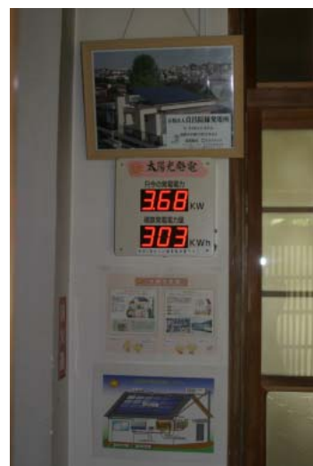
客間玄関の大型発電量表示装置
